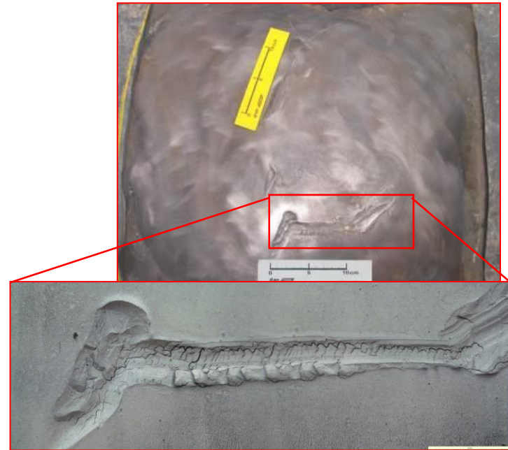
Riefe aufgrund Baggerschaden
