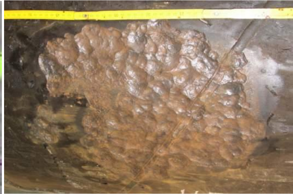
Foto der Flächenkorrosion (alte Kokereigasleitung ohne KKS)
