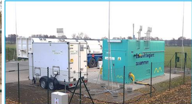
Einspeiseanlagen in Schopisdorf bei Berlin zur Versorgung von ca. 350 Haushalten mit einem H 2 -Erdgasgemisch (20/80)
