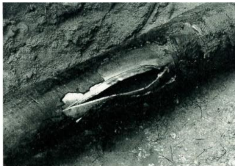
Bild 9. Ein schadhaftes Rohr innerhalb des Prüfabschnitts 1, an dem der Rohrbruch bei 194 atü nach der dritten Druckbelastung und 5 min Standzeit auftrat.
