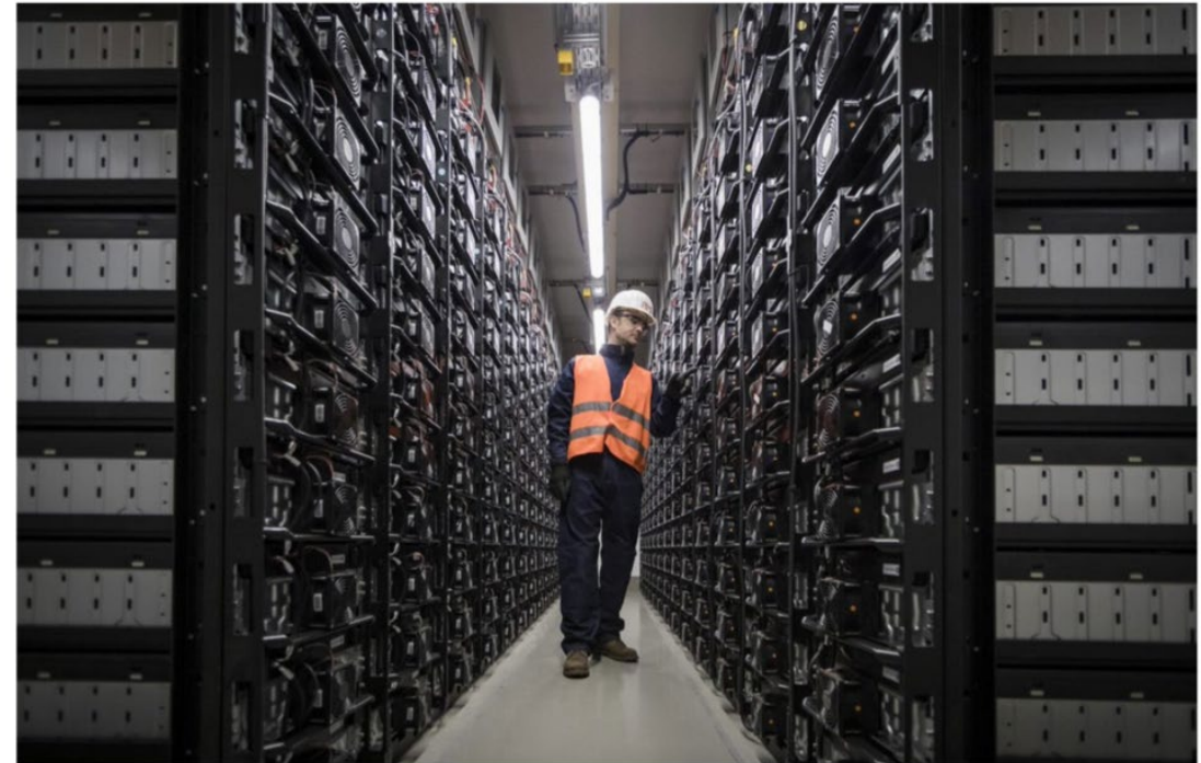
Regelenergie: 10 MW-Batteriespeicher von RES für VBB fertiggestellt, Neue Energie, https://www.contextcrew.de/regelenergie-10-mw-batteriespeicher-von-res-fuer-vbb-fertiggestellt/
