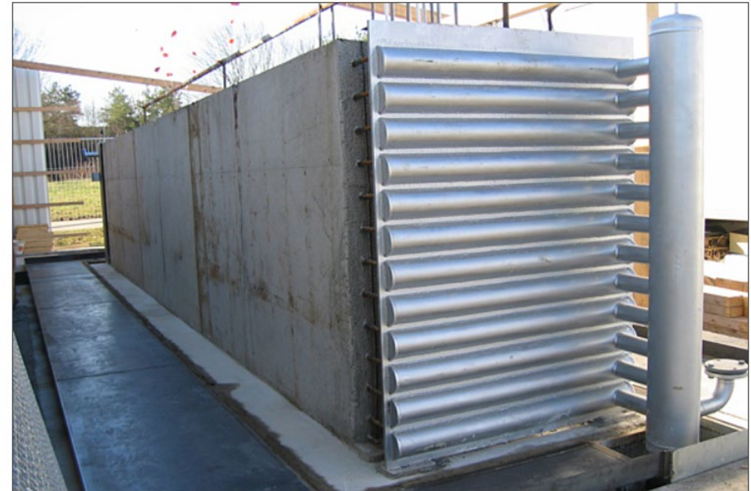
Betonspeicher - Pilotanlage in Kooperation mit der Firma Züblin beim DLR in Stuttgart. Bild: DLR. Bild
