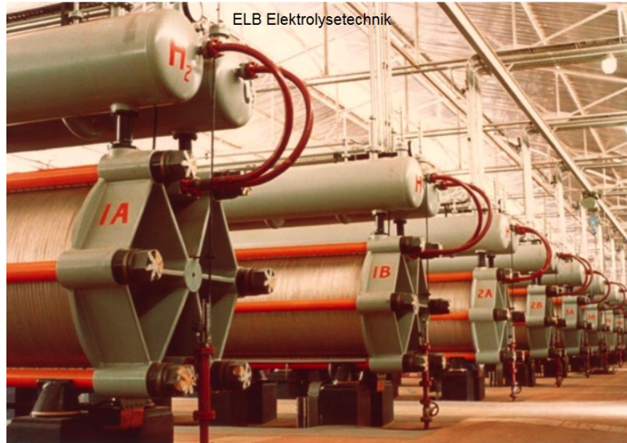
28 Elektrolyseure a 760 m N 3 /h H 2 für die Düngemittelherstellung (Zimbabwe) Gesamtkapazität von 21.000 m N 3 /h H 2 , installiert in den Jahren 1972 – 1974
