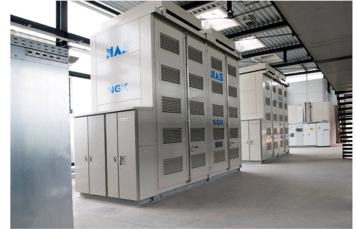
Zukunft der PV-Akkutechnologie: Die Natrium-Schwefel-Batterie im Detail, Greenhouse Media,
