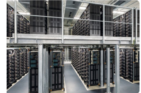
Batteriespeicherpark von innen: In den insgesamt 1.600 Trays verbergen sich 25.600 Lithium-Manganoxid-Zellen
